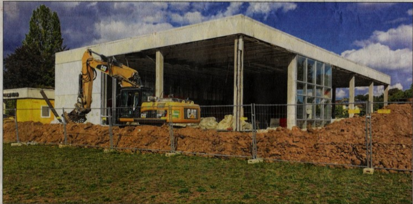
DIE TAGE SIND GEZÄHLT. In Östringen bricht eine Spezialfirma derzeit das Hallenbad an der Johann-Strauss-Straße ab. Ende dieses Monats sollen die Arbeiten beendet sein. Eine Sanierung des maroden Gebäudes hätte sich nicht mehr gerechnet. Foto: br
